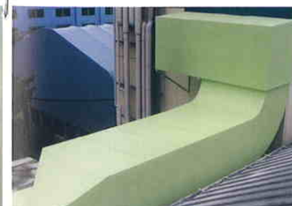
ダクトの放熱防止
