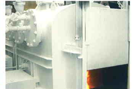
保温、火傷防止、劣化防止
